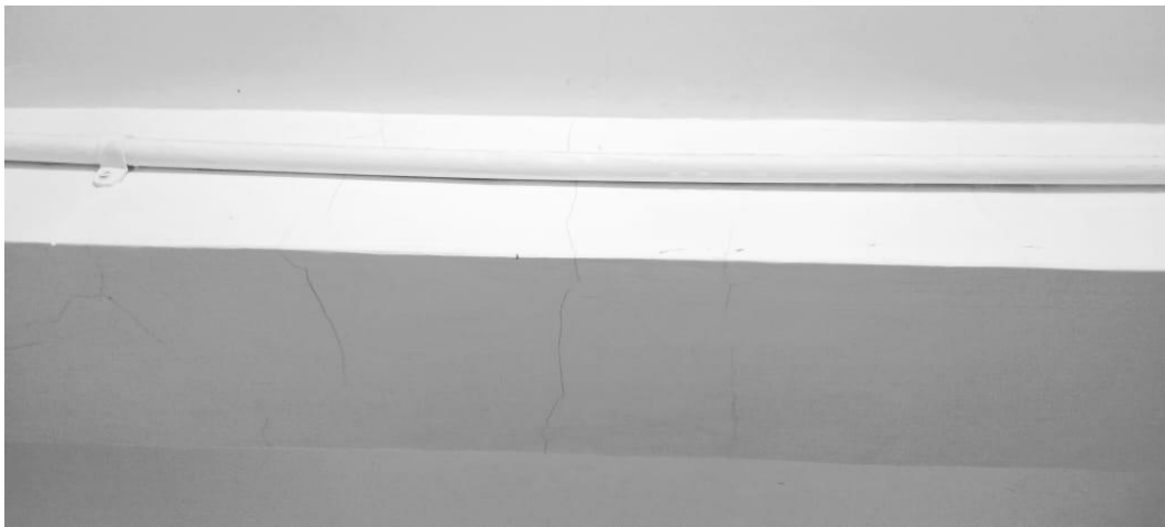
Gambar 2. Salah Satu Struktur BT yang Mengalami Retak Lentur dan Retak Geser di HKBP Titi layang
